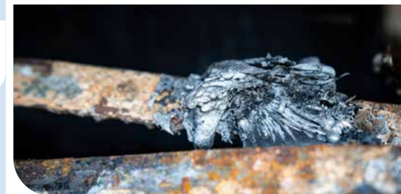
A hő hatására megolvadt alumíniumvezeték maradványa
